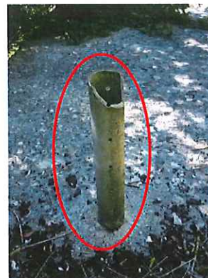
Une des ventilations aval, non évacuées en hauteur
