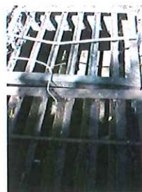
Un des regards de la fosse toutes eaux présentant un défaut de structure
