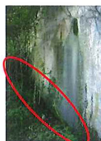
Résurgences constatées au niveau du prétraitement
