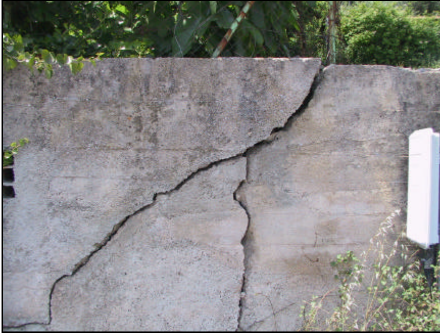
Photographie 2. Mur fissuré par une poussée des terres en amont.
