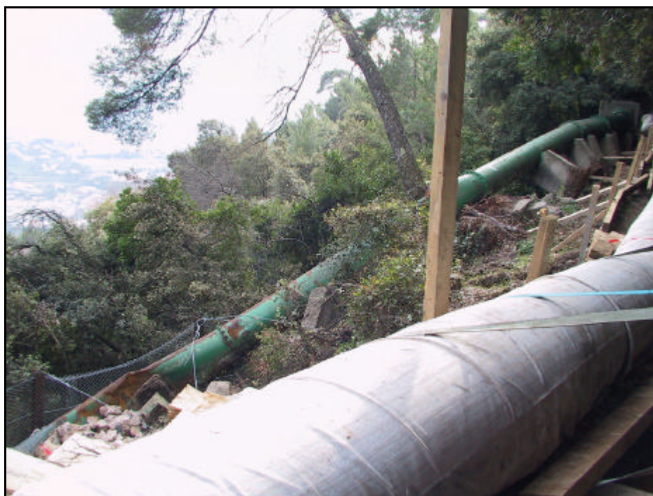
Photographie 12. Eboulement survenu à proximité du Foulon.
