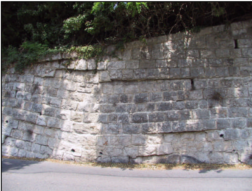
Photographie 3. Affaissement d'un mur engendré par un mouvement de terrain.
