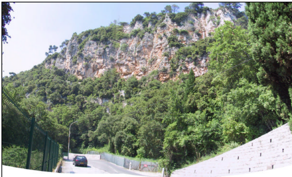
Photographie 9. Falaise qui surplombe la zone de risque de grande ampleur de chutes de rochers et de pierres.
