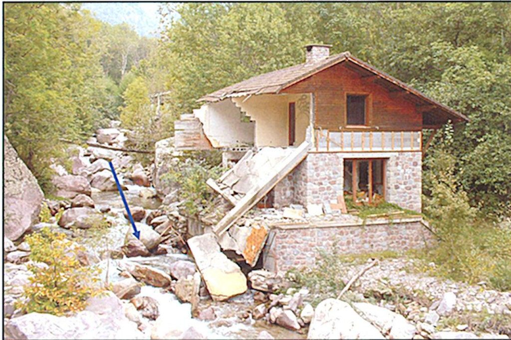
Photographie 5 - Dégâts occasionnés par la crue de 1994 (prise de vue en 2002)
