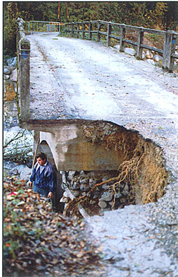
Photographie 2 - Pont du Véséou, dégâts dus à la crue de la Gordolasque de 1997.
