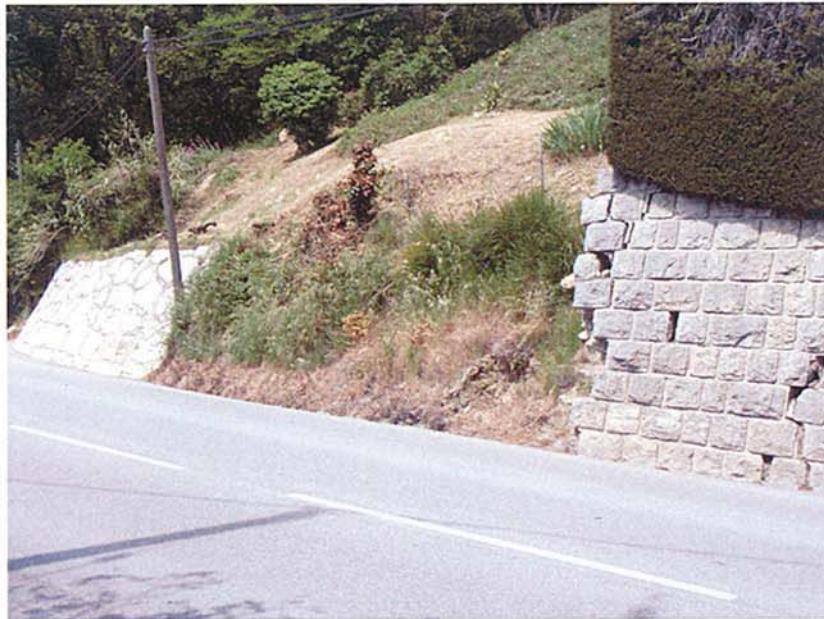
Photo n° 8 : Vue de la partie effondrée du mur de soutènement côté amont de la RD3
