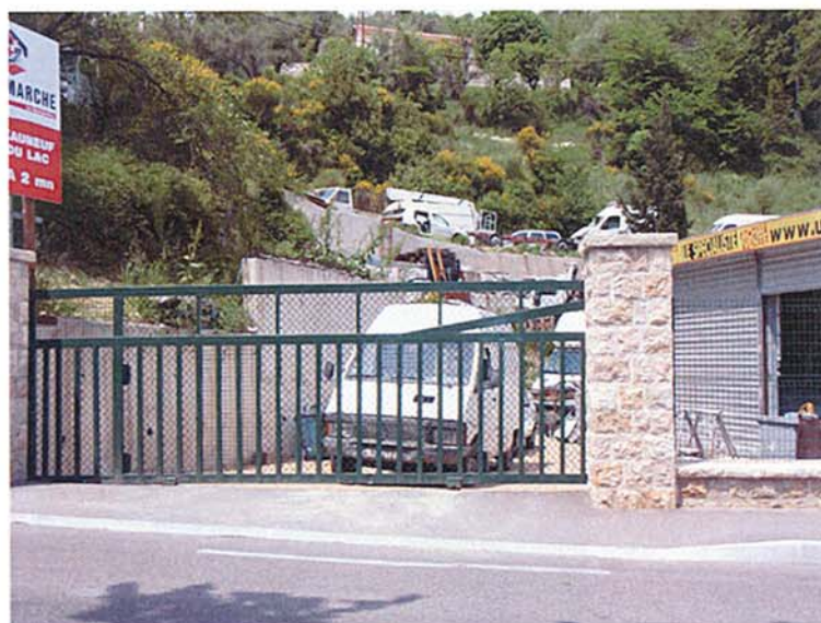
Photo n° 17 : La Gypsière. Mur de soutènement et couronne instable en amont (Voir ouvrage n°1 de la carte des phénomènes)
