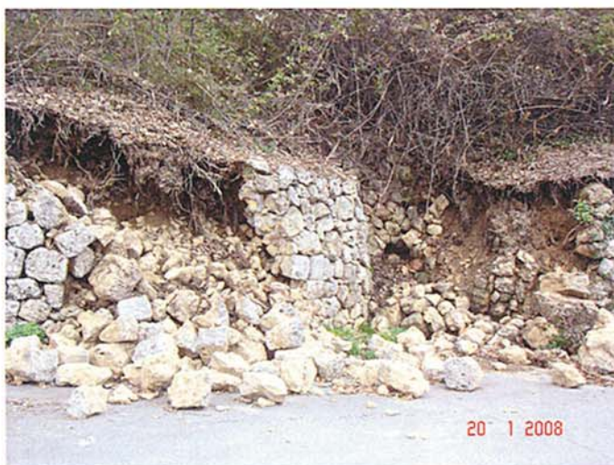
Photo n° 12 : Muret effondré chemin des Groules
