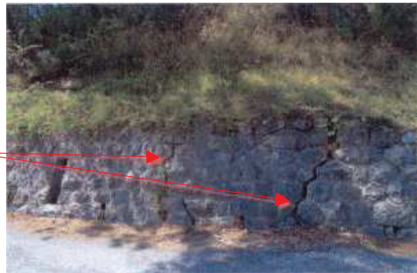
Poussée des terres avec apparition de fissures entraînant la déstabilisation du muret.
