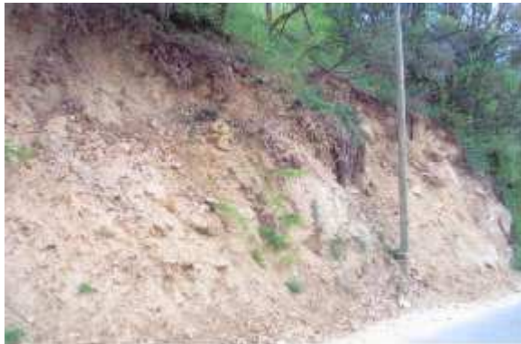
Arrachement du talus amont sur le chemin menant à Calempol
