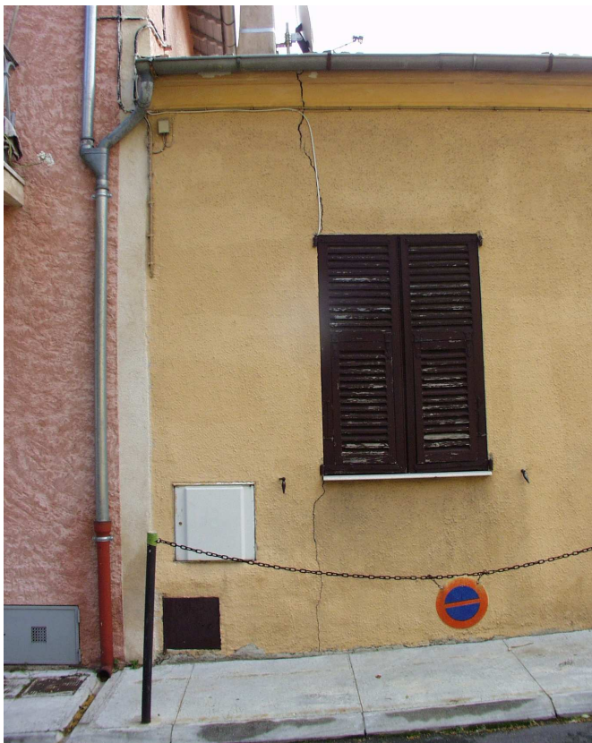
Exemple d'indice de déstabilisation sur une habitation du quartier du Paran
