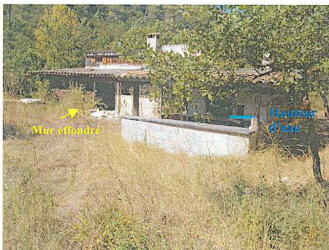
Photo n°20 : A la limite communale, rive droite cabanon inondé par la crue de 2000
