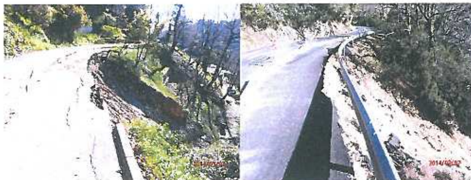
Photo n° 16 et 17 : route des Ciappes effondrée en amont de la propriété de MM. Nehl Route des Ciappes effondrée en aval de la propriété de MM. Nehl
