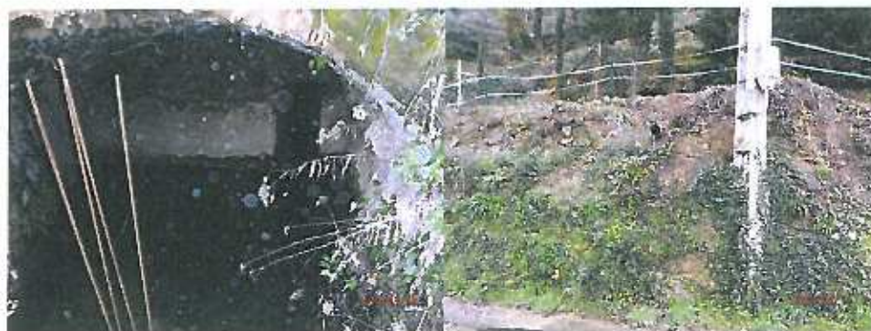
Photo n° 14 et 15 : Barme au-dessus de la route du Mont-Gros Surverse de la barme (propriété de MM. Nehl)
