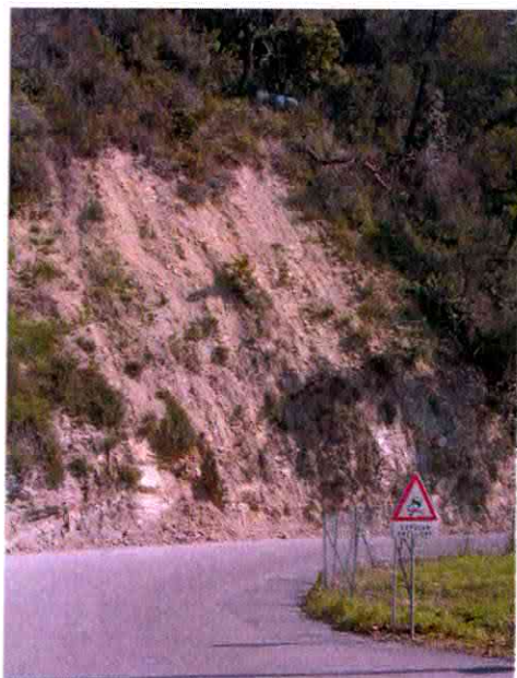
Eboulement - carrefour route de la Colle – chemin des Arnauds
