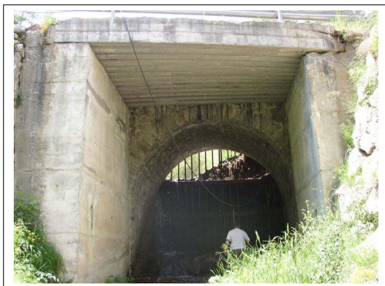
Photo n°4 : grille obstruée par des matériaux issus du torrent sur l'ancienne route départementale.
