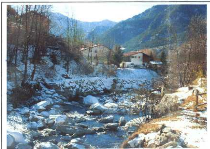
Photo 7 : protection de berge affouillée en rive gauche du Boréon, quartier de la Loubonnière
