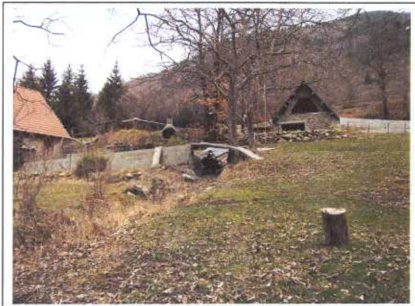
Photo n°11 : Vallon obstrué par l'extension du chalet et par le stockage de matériaux divers.
