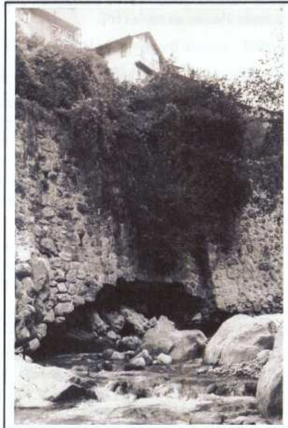
Cliché RTM-06, 1965 – photo n°2 : Digue affouillée par la crue du 1 er octobre 1965
