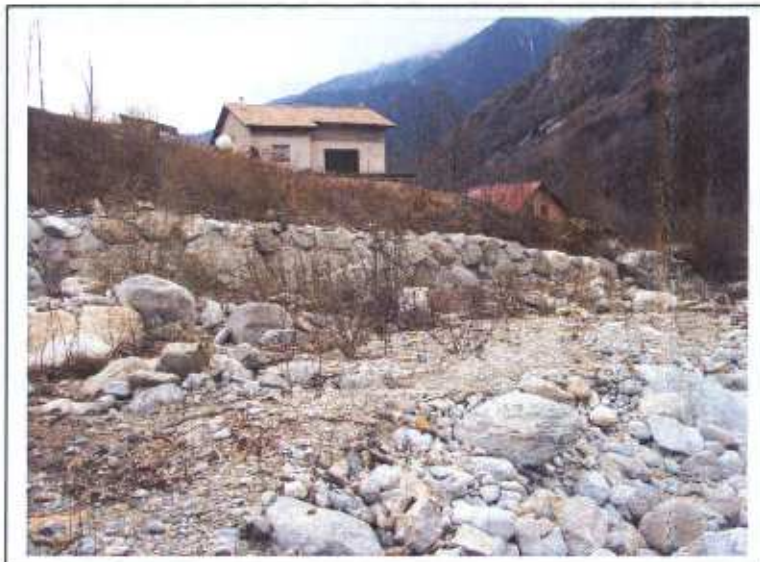
Photo n°10 : enrochements bétonnés pour protéger la berge. Le chalet au toit rouge en arrière plan est menacé par les crues de la Vésubie.
