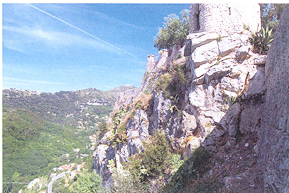
Calcaires du Jurassique soumis au phénomène d'éboulement Vue située sous les jardins du château.
